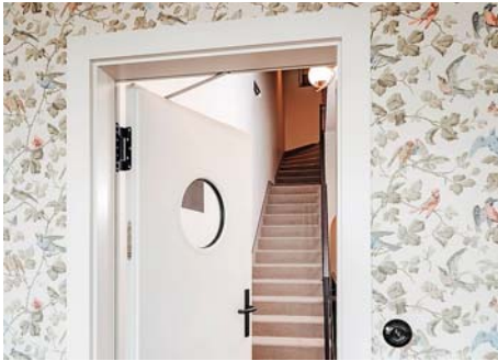
/ Die Brandschutz-Korridorüren mit Bullauge wurden mit einem integrierten Türschließer ausgestattet.
